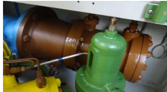
Abb. 1: Metallbauteile mit PCB-haltigem Korrosionsschutz
