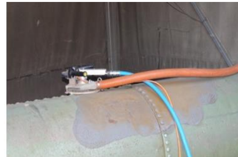
Abb. 5: Saugglocke auf einem Druckleitungsrohr
