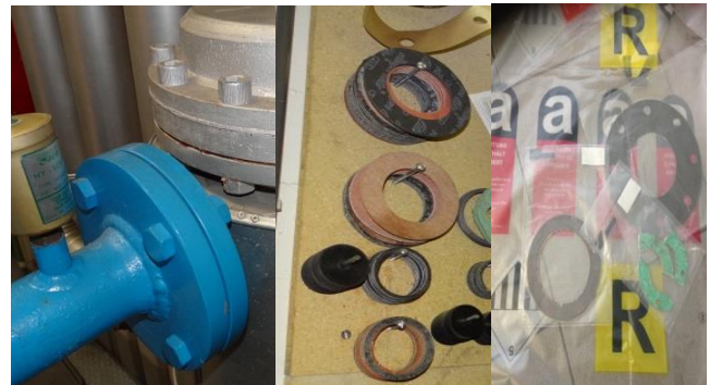
Abb. 1: Flansch mit asbestverdächtiger Dichtung
