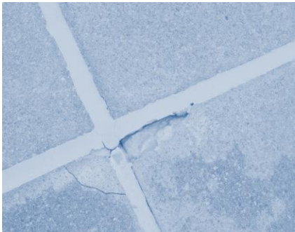
Bild 12: SCCP-haltige Fugen (Quelle ETI)
