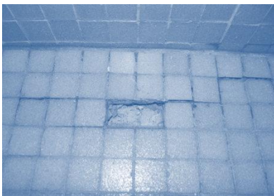
Bild 1: Fliesen mit asbesthaltigem Kleber (Quelle ETI)
