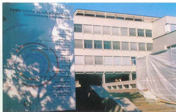
Das Schulhaus der Gewerblichen Berufsschule in Chur wurde vor 35 Jahren gebaut. Ein typischer Fall für eine PCB-Sanierung.
